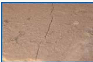
Стяжка с трещинами
